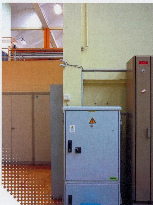
Un autre type d'armoires, non métallique, posée au sol.
